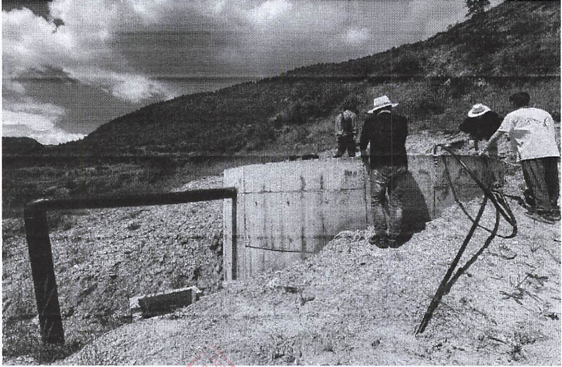
50m 3 蓄水池、10m 3 蓄水池：
